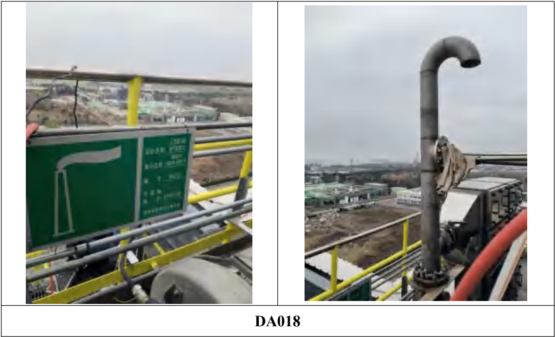
图 4.1-2 有组织废气排放口
