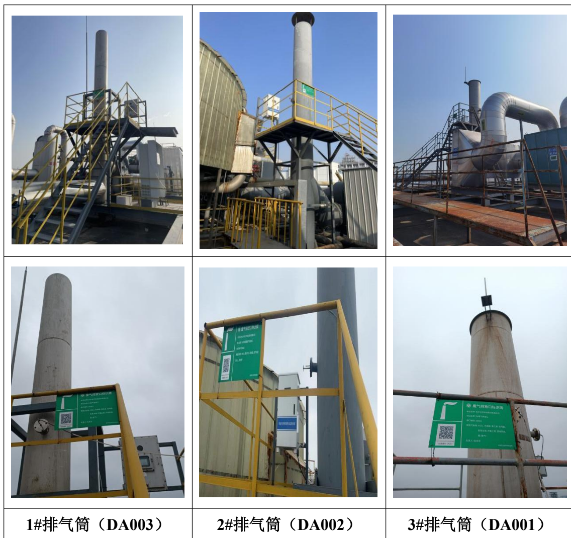
图 4.1-4 有组织废气排放口
